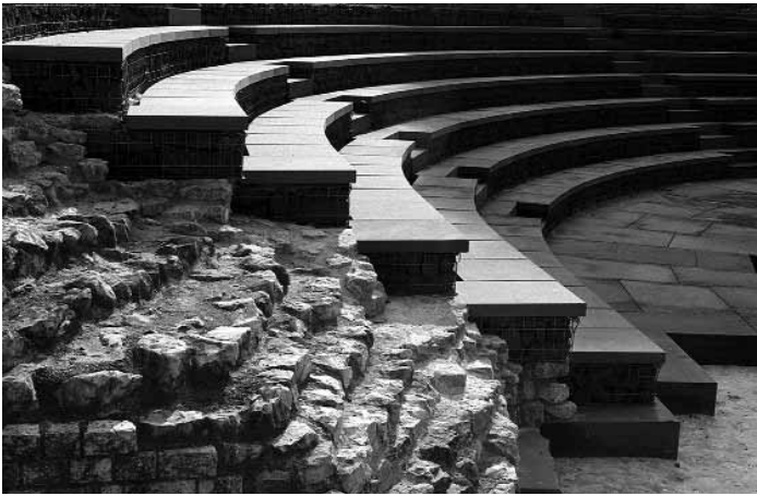
Die Theatersanierung schreitet plangemäss voran. Bereits wird erkennbar, wie sich die unteren Sitzränge am Schluss der Arbeiten 2006 präsentieren werden. Auf die dann wieder möglichen Konzerte und Freilichtspiele darf man gespannt sein. (Foto Ursi Schild)
